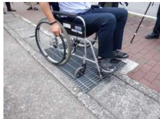
歩道（伊勢南島線） グレーチングの目が粗い。
