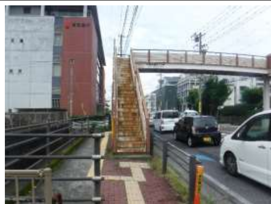
歩道（伊勢南島線：県-6） 歩道橋の脚の部分の幅員が狭い。
